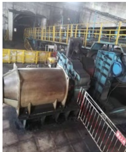
带式输送机监控——煤矿厂
