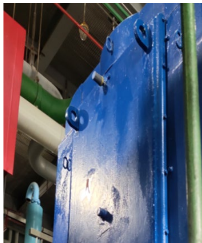
凝结水泵监控——发电厂
